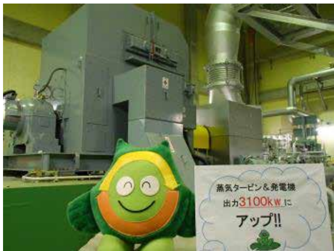
クリーンセンター内 発電機
